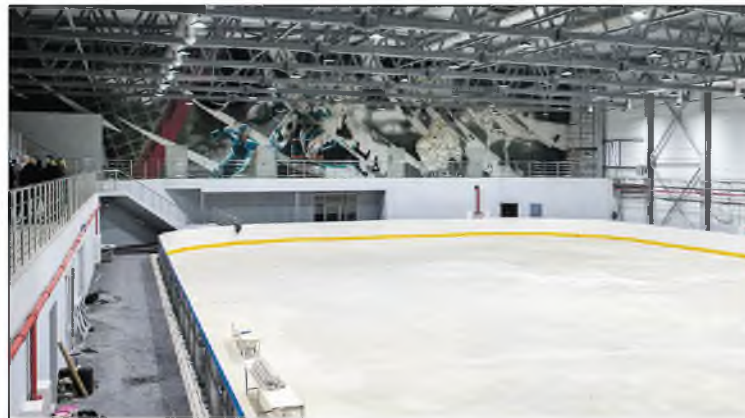
Ноябрь 2021 года. До открытия нового Ледового дворца в городе химиков остался месяц. Сейчас завершается внутренняя отделка помещений.
